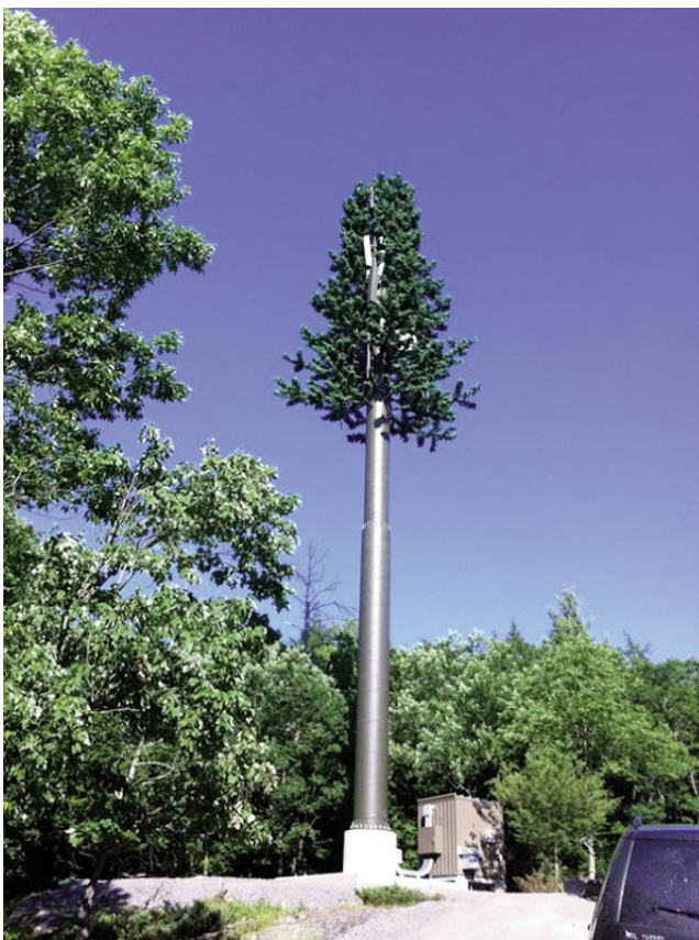
Antenne relais de téléphone mobile partiellement déguisée
